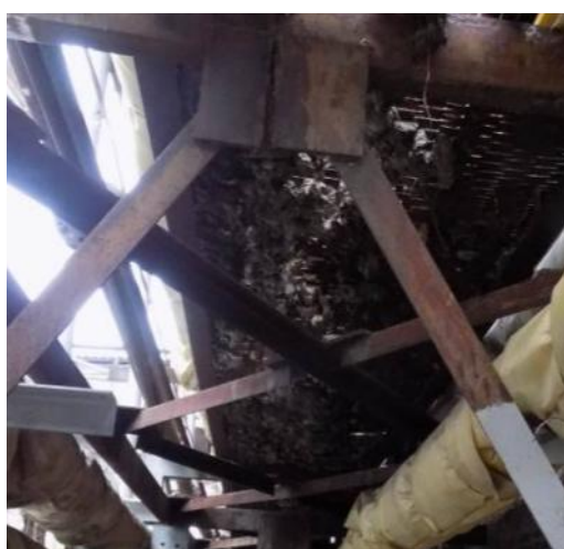
Рис. 5. Отсутствие защитного антикоррозионного покрытия, и как следствие, коррозия элементов пролетных конструкций между опорами
