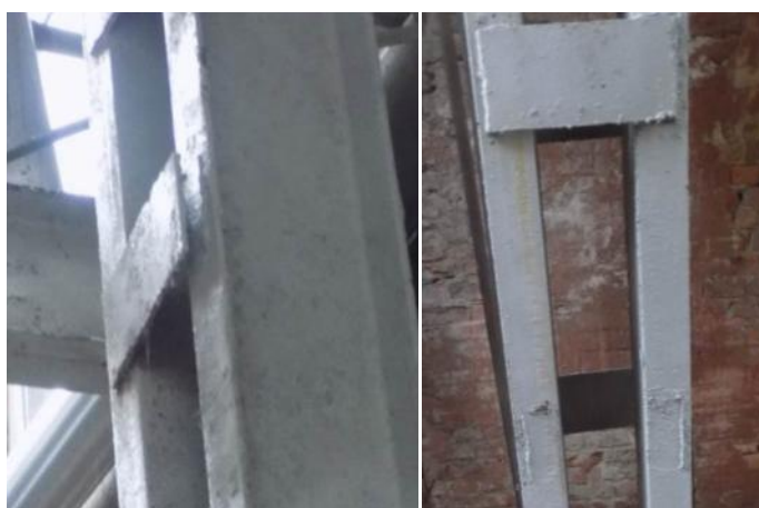
Рис. 4. Вид отрыва планок на металлических опорах
