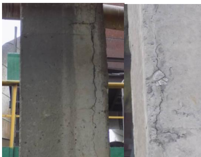
Рис. 1. Вид трещин в защитном слое бетона
