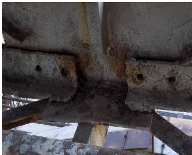
Рис. 3. Вид трещин в сварных соединениях
