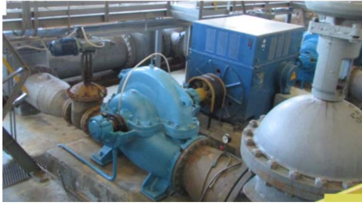
Рис. 1. Центробежный насосный агрегат на водоподъёмной станции
