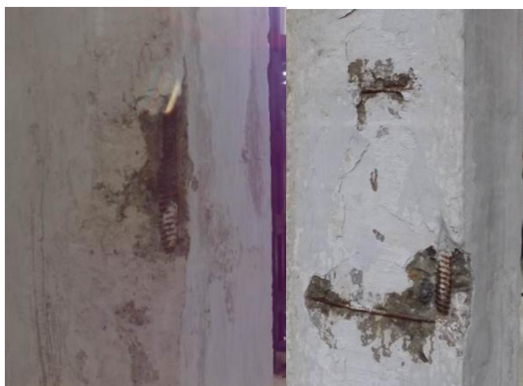
Рис. 2. Вид оголения и коррозии арматуры
