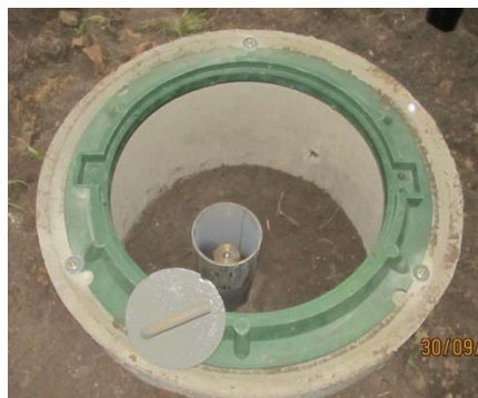
Рис. 1. Внешний вид глубинного опорного репера
