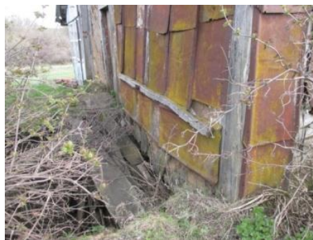
Рис. 4. Вид частичного разрушения фундамента
