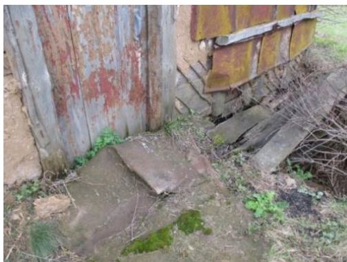
Рис. 8. Вид участка древесины с признаками гниения
