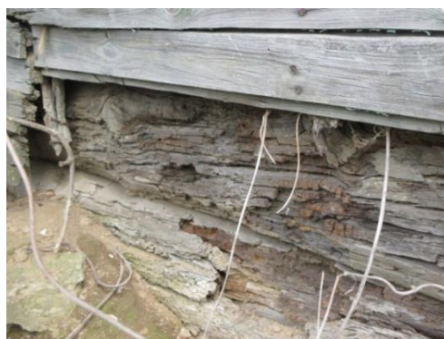
Рис. 7. Вид участка древесины с признаками гниения
