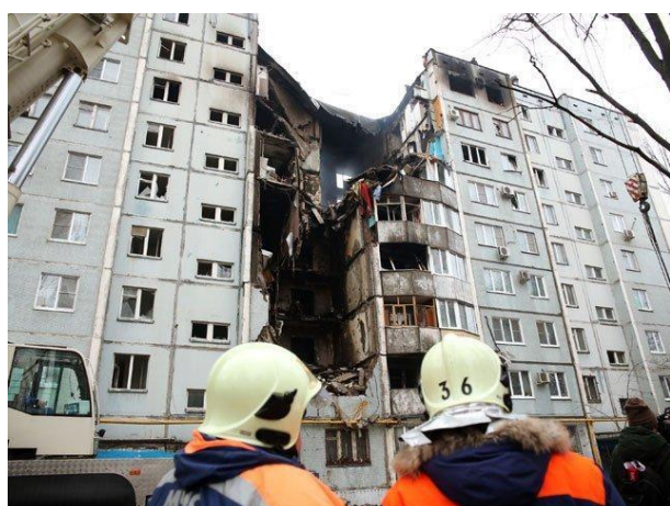
Рис. 8. Фрагмент подъезда после обрушения конструкций
