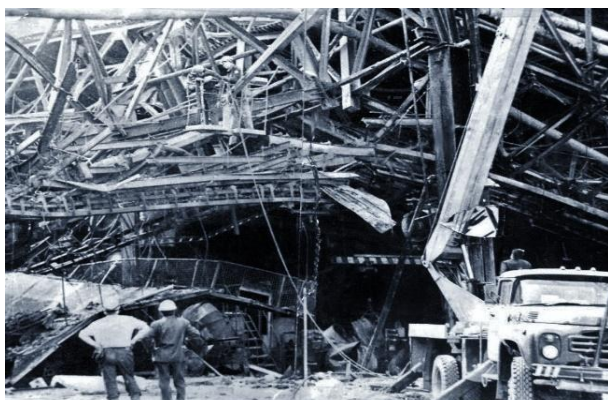
Рис. 4. Деформированные стальные конструкции после пожара
