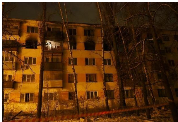
Рис. 9. Дом в Воронеже после пожара
