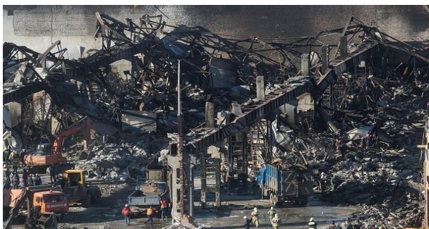
Рис. 1. Фрагмент ТЦ «Адмирал» после пожара
