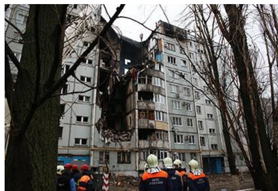
Рис. 2. Обрушение подъезда дома после пожара
