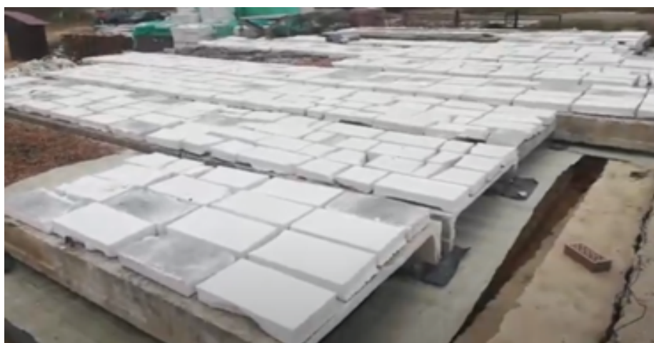
Рис. 1. Плиты перекрытия с шумоизолирующим материалом, но без арматурной сетки и каркасов
