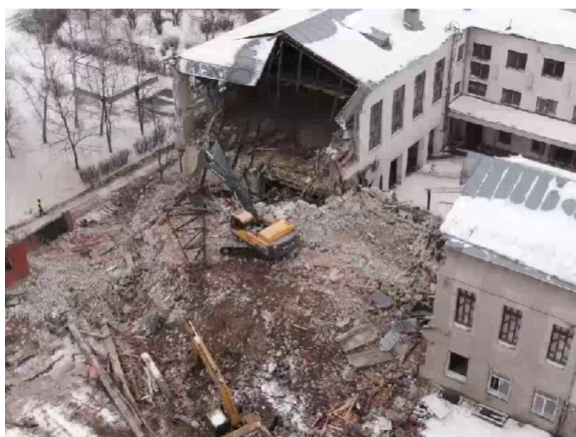
Рис. 3. Разрушение ДК 50-летия Октября, г. Воронеж
