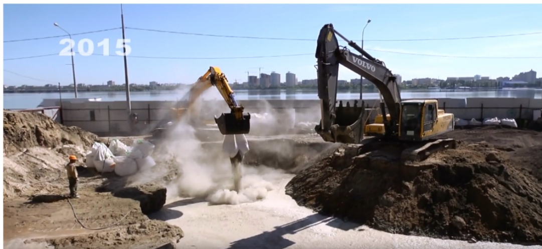
Рис. 1. Объемная цементация грунтов с повторным использованием боя каменных стеновых материалов, образующихся при сносе зданий
