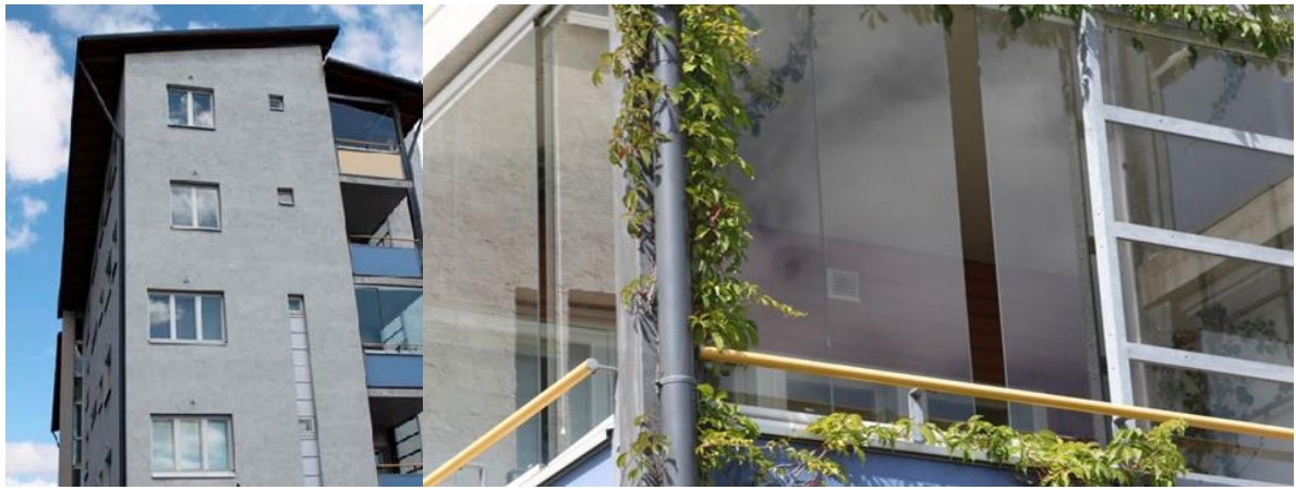
Фото 28. Приточные решетки системы поквартирной вентиляции на фасадах зданий в Виикки
