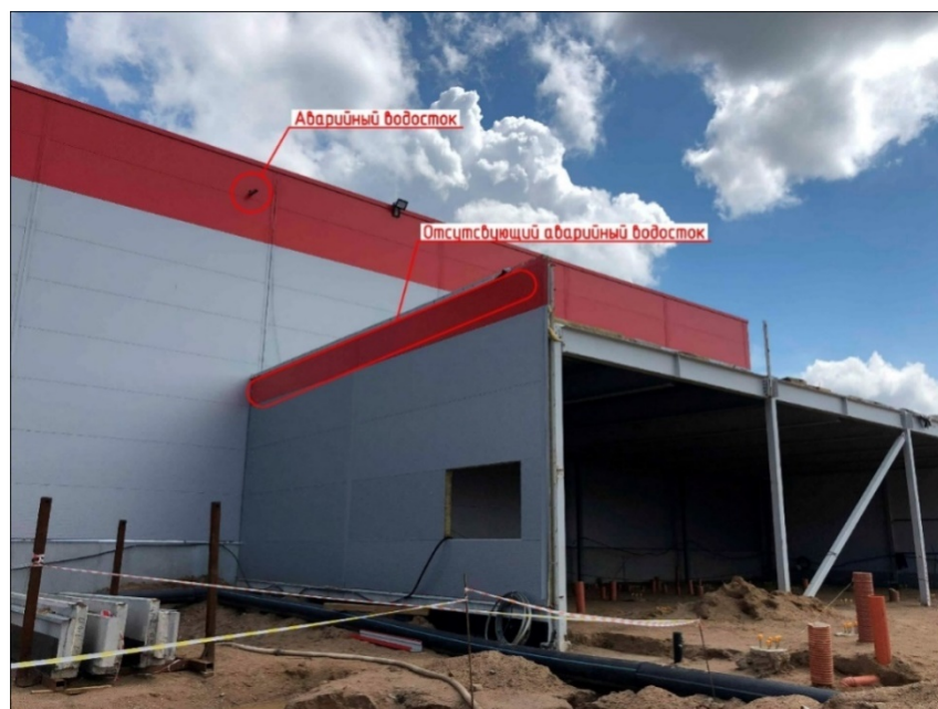
Рис. 3. Отсутствие аварийного водостока
