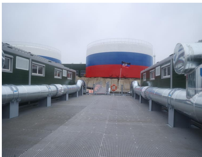
Рис. 2. Две нити трубопровода
