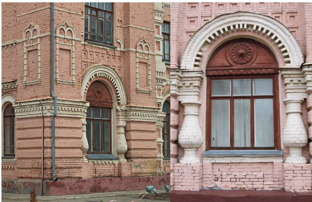
Рис. 3. Фото «Здания ссудо-сберегательного товарищества». Детали фасада. Источник фото: https://photobuildings.com/photo/02/05/04/205046.jpg Источник фото: https://vif-vrn.ru/viewtopic.php?t=1489
