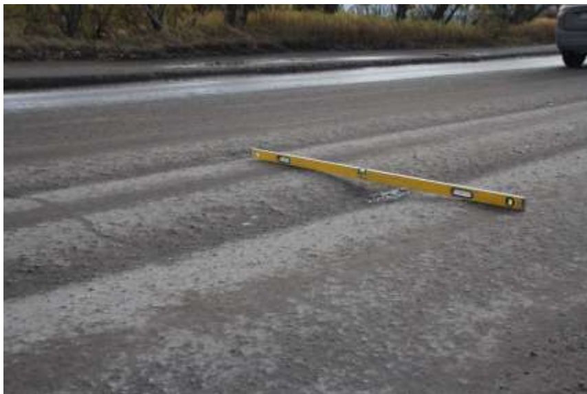
Рисунок 1.13 - Колея на асфальтобетонном покрытии
