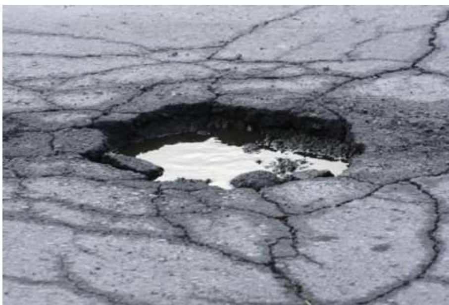
Рисунок 1.12 - Выбоины на асфальтобетонном покрытии
