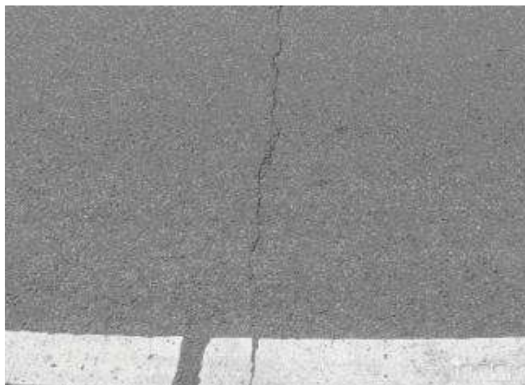
Рисунок 1.11 - Трещина на асфальтобетонном покрытии
