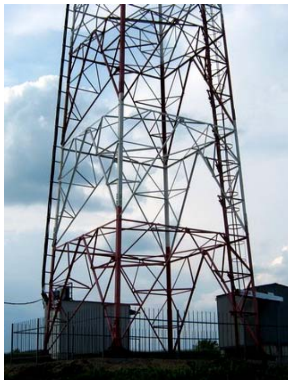
Рис. 3. Общий вид решетчатой башни углового сечения «Энергомаш» сети «Вотек Мобайл»
