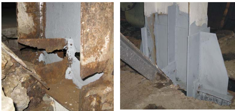
Рис. 2. Характерные повреждения и усиление стальных колонн на уровне перекрытий
