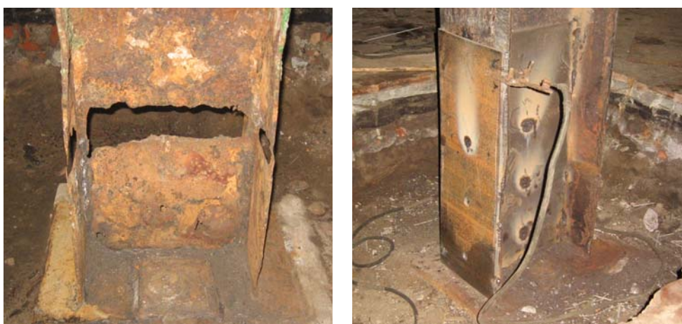
Рис.1. Характерные повреждения и усиление стальных колонн на уровне опорных баз
