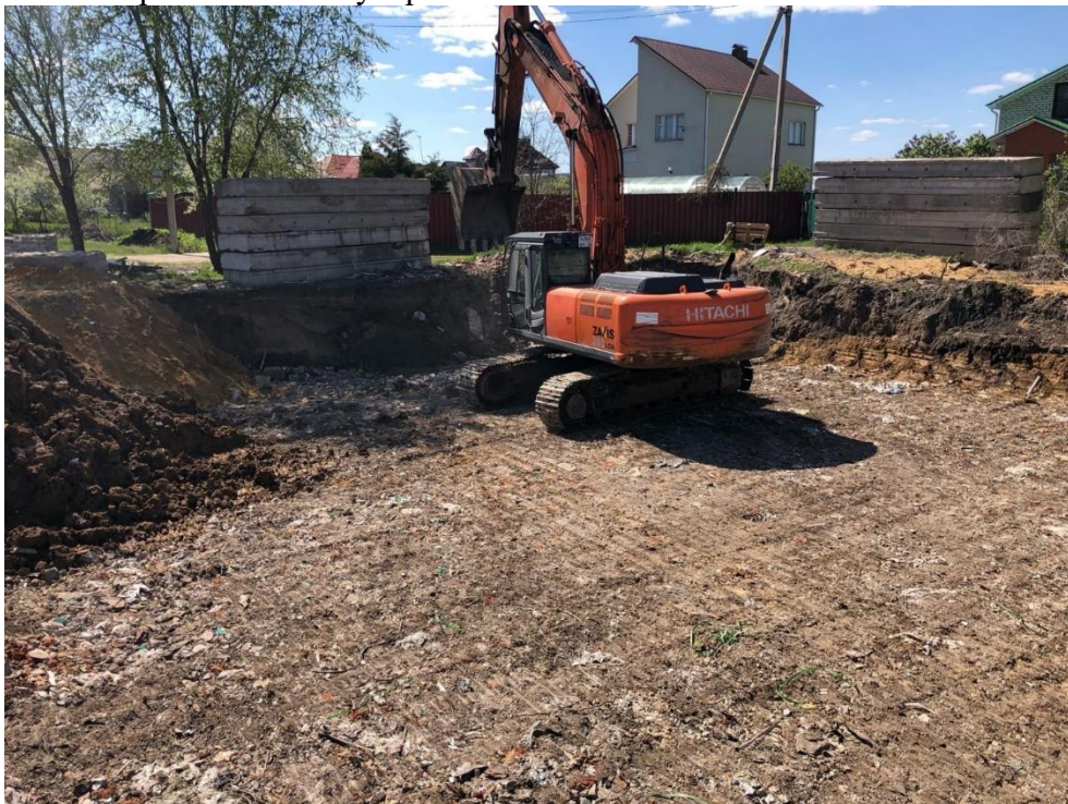
Рис. 4. На фото мы видим котлован одного из наших строительных объектов, основанием которого являются заранее укрепленные глинистые грунты при помощи боя каменных строительных материалов. Экскаватор утрамбовывает их.
