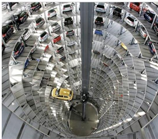
Рис. Механизм-приемник в башенной автоматической парковке
