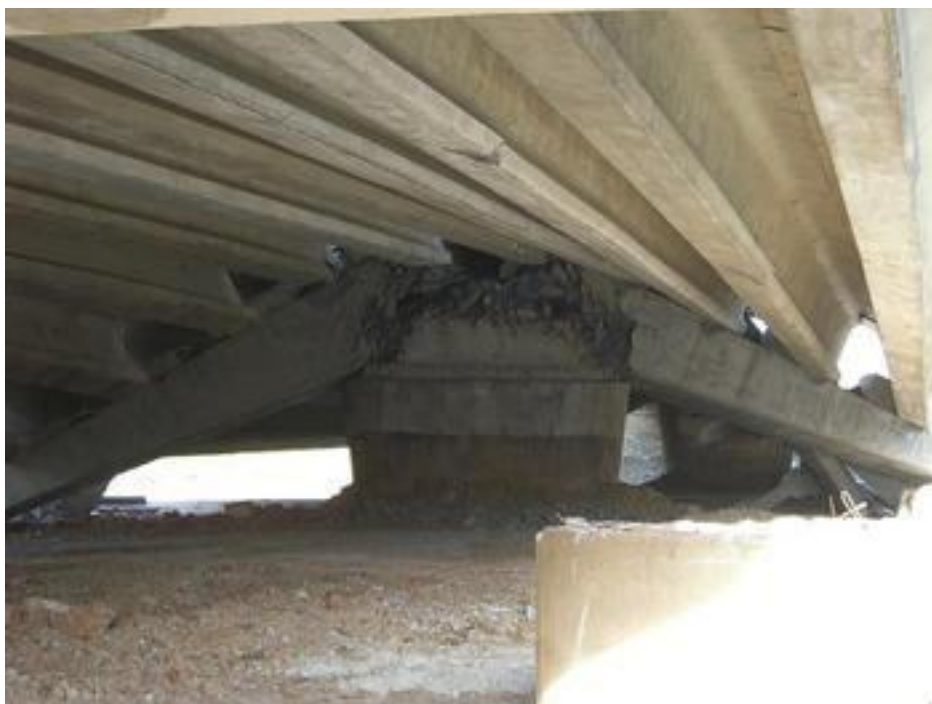
Рис.1. 04 сентября 2006 г рухнул строящийся путепровод через ж.д. в Екатеринбурге – разрушение сначала по бетону, потом – по арматуре (по некачественной сварке в растянутой зоне).
