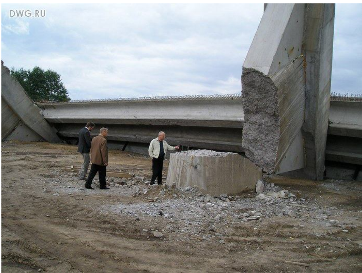
Рис.2. Фактически выполненные работы и авария в августе 2006 г.
