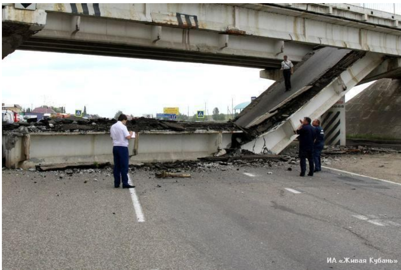
Рис.2. 20 мая 2010 г в республике Адыгея рухнул пролет путепровода через М-4. Видна огромная толщина лишнего слоя покрытия, вероятно, еще и коррозия арматуры – разрушение как будто произошло по арматуре (не видно выкрашивания сжатой зоны).
