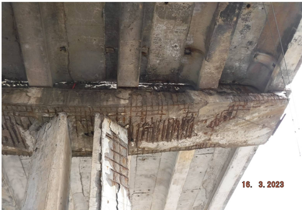
Рис. 2. Разрушение наружных слоев бетона с оголением и коррозией рабочей арматуры ригеля вследствие длительного неблагоприятного воздействия агрессивных жидкостей
